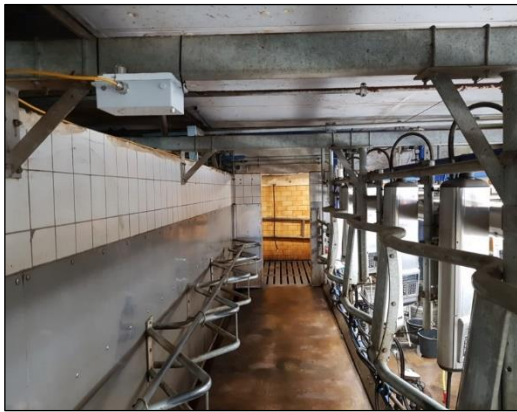
Abbildung 8) Basisstation an der Decke eines Melkstandes
